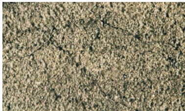
Altputz mit Rissen
