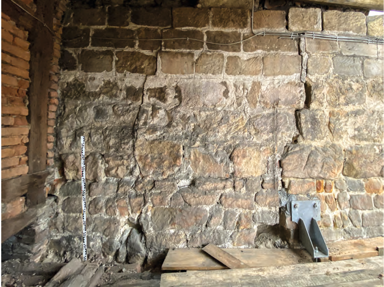
Abb. 3: St. Gangolf, Nordmauer des Kreuzganges. Brandgeschädigtes Mauerwerk im Dachraum des Kreuzganges. (Foto: B. Marr, 2019).
